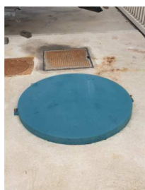
Cuve de stockage
