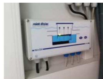
Système de contrôle du séparateurs
